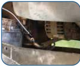
Fuga en toma de baja presión.
